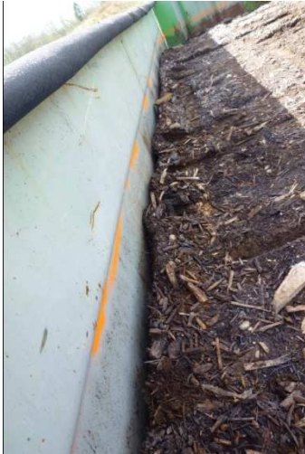
Photo 10 : espacements et tassements côté droit (pilote B)
